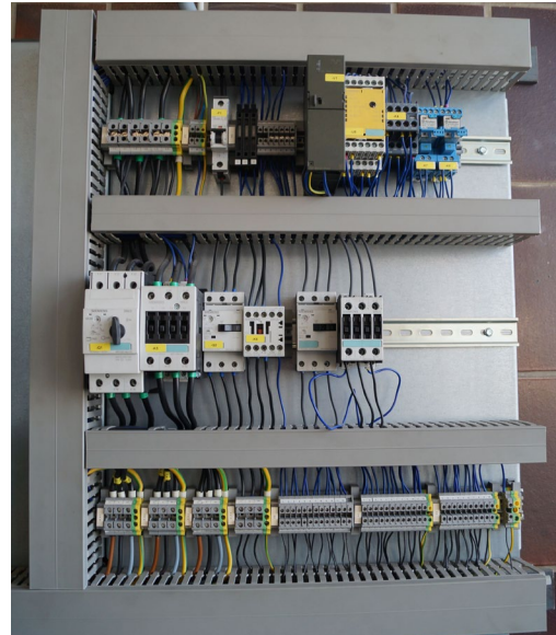
Abbildung 14: Schaltgerätekombination für Prüfung von Servomotoren (Quelle: Klebs+Hartmann GmbH & Co. KG)
