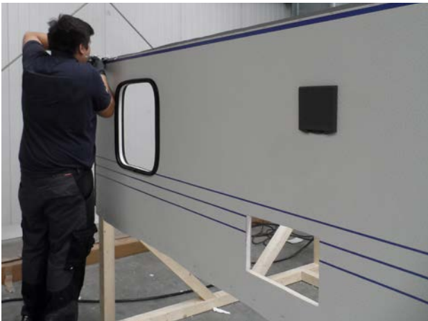
Abbildung 40: Instandsetzungsarbeiten an einer Sandwichplatte (Quelle: P. Lindner, Niesmann Caravaning GmbH & Co. KG)
