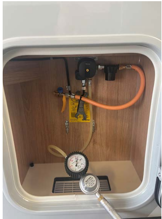
Abbildung 28: Druckprüfung an einer Flüssiggasanlage, welche zu Koch- und Heizzwecken in Caravans und Reisemobilen Verwendung findet (Quelle: ZKF)
