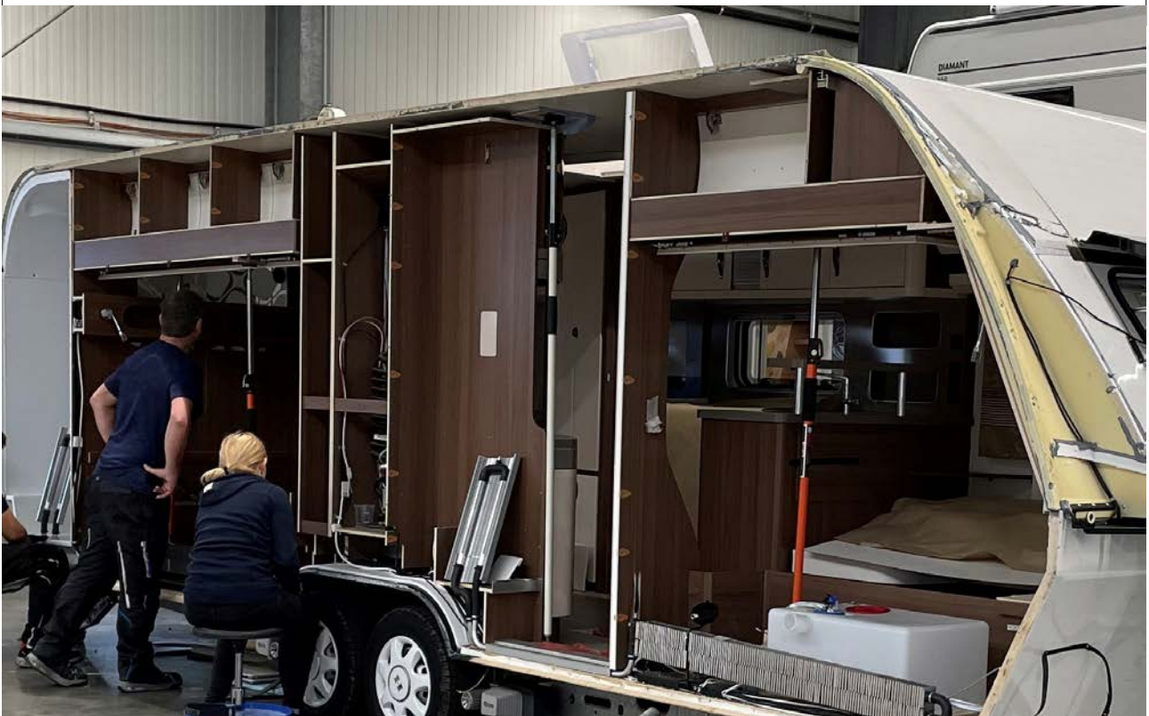
Abbildung 12: Karosserie- und Fahrzeugbaumechaniker/-in in der Fachrichtung Caravan- und Reisemobiltechnik beim Ersetzen einer Seitenwand eines Caravans (Quelle: P. Lindner, Niesmann Caravanning GmbH & Co. KG)
