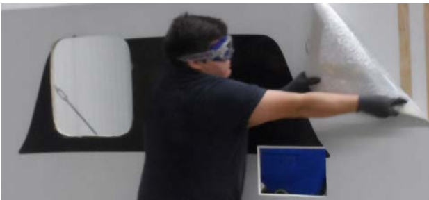
Abbildung 41: Entfernen des Deckblechs an einer Sandwichplatte (Quelle: P. Lindner, Niesmann Caravaning GmbH & Co. KG)
